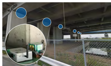
加速度センサと無線機の設置により、災害発生時などの橋桁や橋脚の異常を遠隔地からリアルタイムに検知可能
